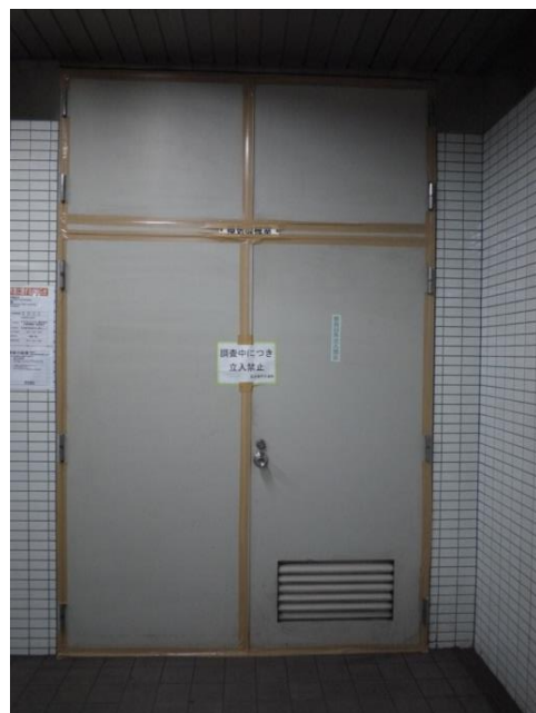
ガムテープで目張りされた機械室の扉（2014年1月撮影）
